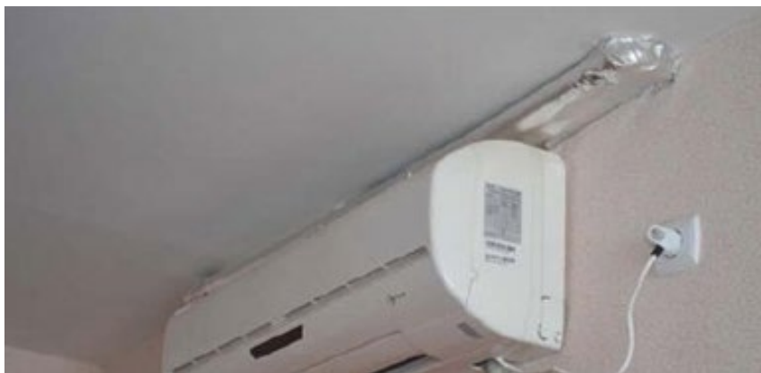
Фото 3. Блок рекуператора в квартире.
