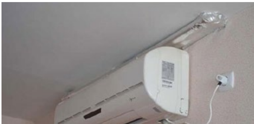
Фото 3. Блок рекуператора в квартире.
