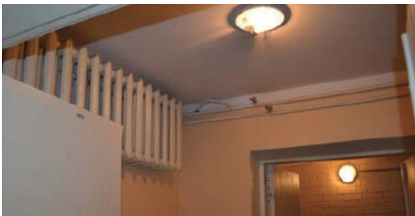
Фото 2. Батарея отопления расположена под потолком в подъезде.
