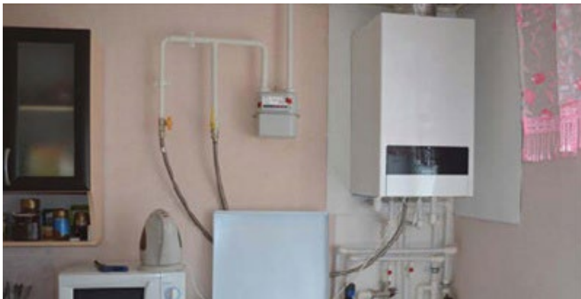
Фото 1. Газовый котел с разводящей системой труб.
