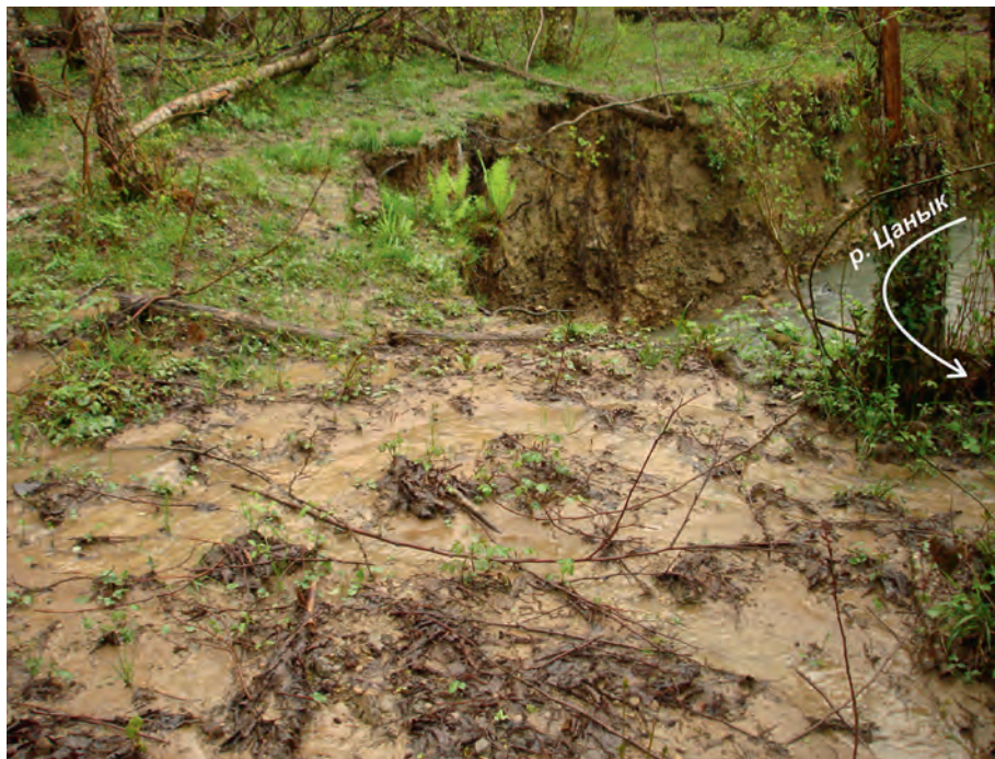
Рис. 4. Поступление овражных наносов в русло р. Цаньк во время паводка, вызванного ливнем 1,5%-ной обеспеченности
