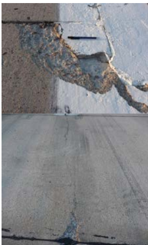
Рисунок 2. Сколы кромок швов плит и трещин, трещины сквозные.
