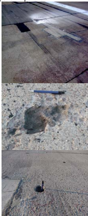
Рисунок 3. Разрушенные плиты, выбоины и раковины
