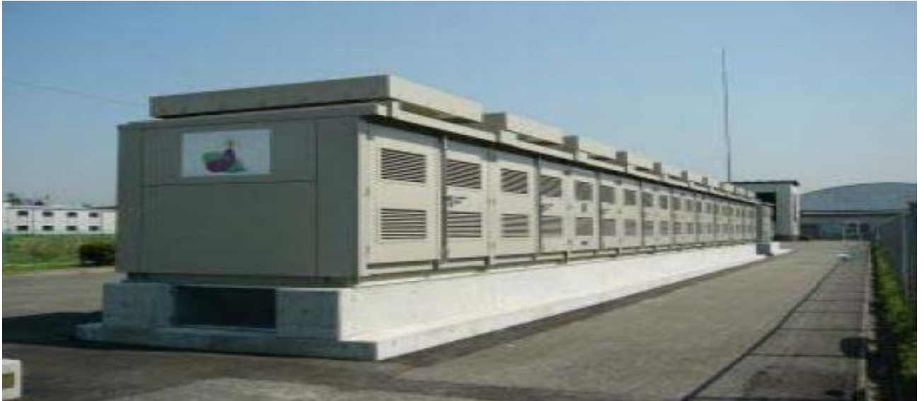
Рис. 2.11 - Аккумуляторные батареи большой энергоёмкости (АББЭ, Япония)
