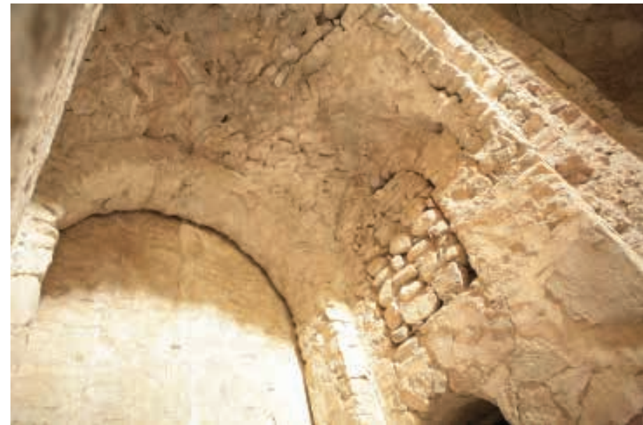
6. Акура. Мама-Давид. Интерьер. Шов между северной стеной северного нефа и поздней прикладкой
