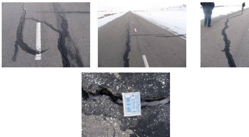
Рис. 1. Трещины на международной трассе БНТ (420–460 км, январь 2016 г.)
